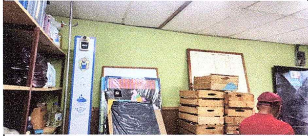
Foto 2: INSTALCION ELECTRICA EN LABORATORIO
